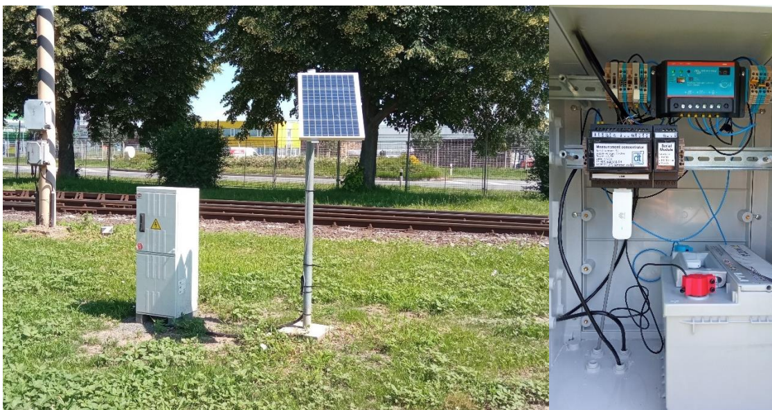
Obrázek 8: Rozvaděč a solární panel pro DISC-S
