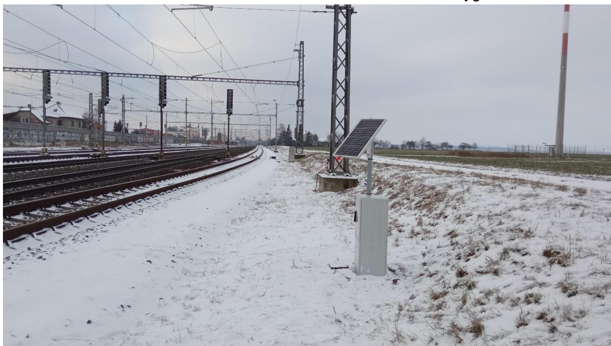
Obrázek 10: Zařízení DISC-S umístěné v trati - Červenka
